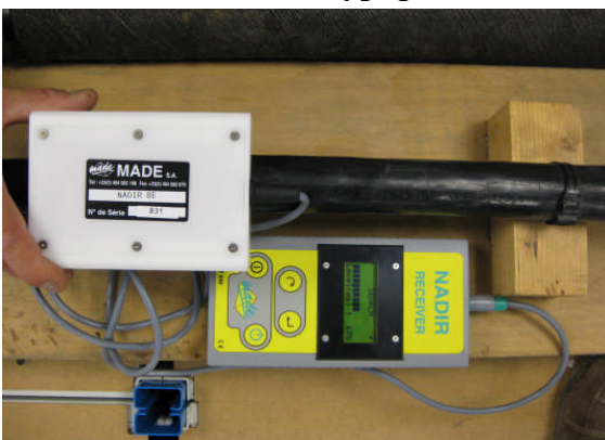
Identification d'un Câble
